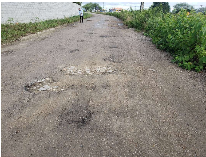
Foto 8 – Pavimento asfáltico danificado
