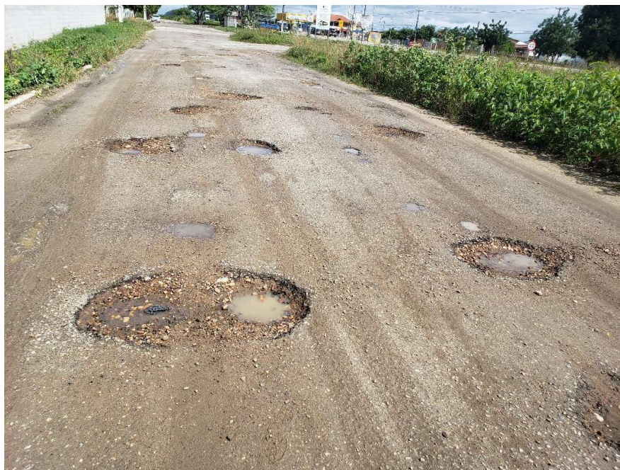
Foto 9 – Vista do pavimento asfáltico danificado
