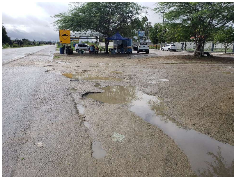
Foto 3 – Canteiros e acessos danificados
