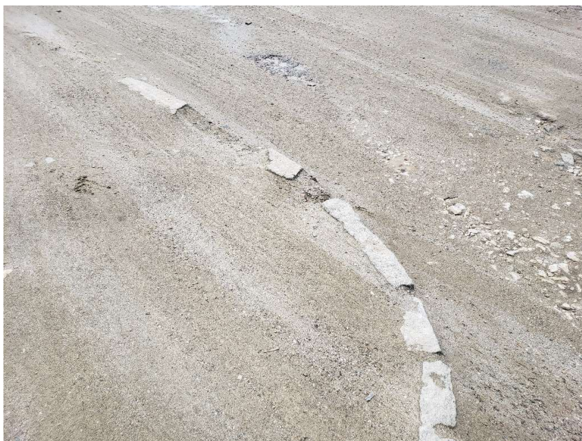
Foto 6 – Meio fio afundado e danificado
