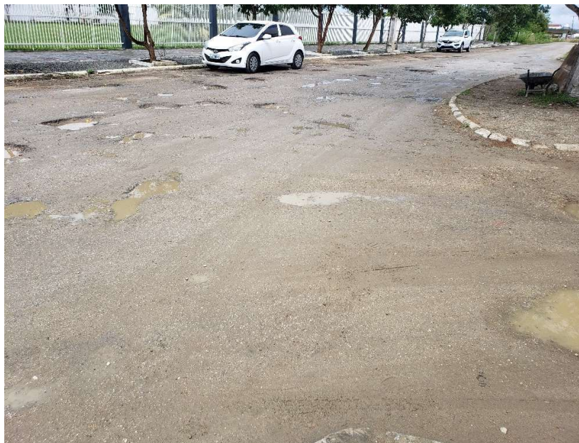
Foto 4 – Acúmulos de água na pavimentação
