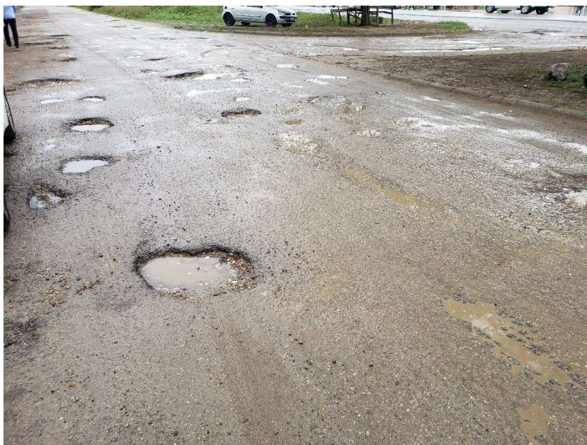
Foto 1 – Vista da via danificada
